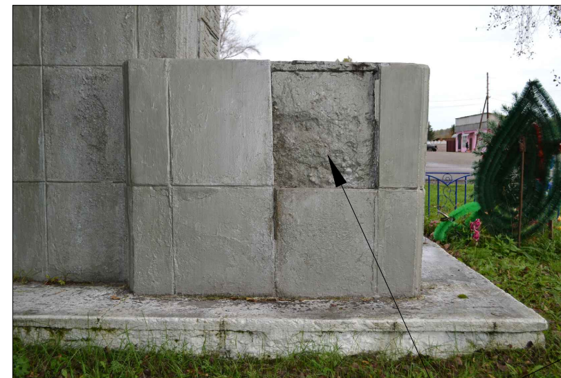
На постаменте отходит плитка
